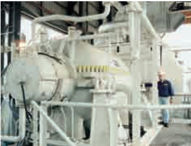
Propane Compressor for Qatar LNG Plant
