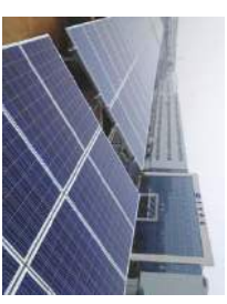
蓝晶科技公司 5MW光伏电站项目 Leng crystal technology 5MW PV power plant
