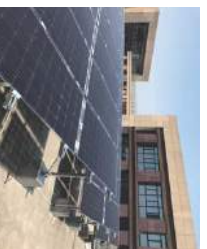
中粮可口可乐4MW 分布式屋顶光伏发电项目 Coca-cola distributed roof photovoltaic project
