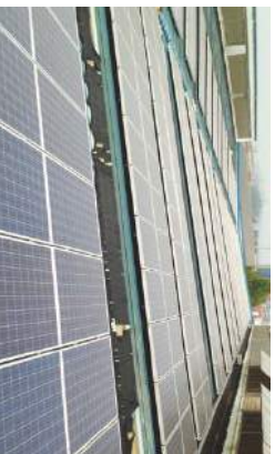
北京光电产业园 15MW光伏电站项目 Beijing 15MW PV power plant
