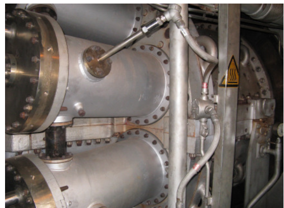
Bild 3: Erdgasbrenner und Brennkammer
