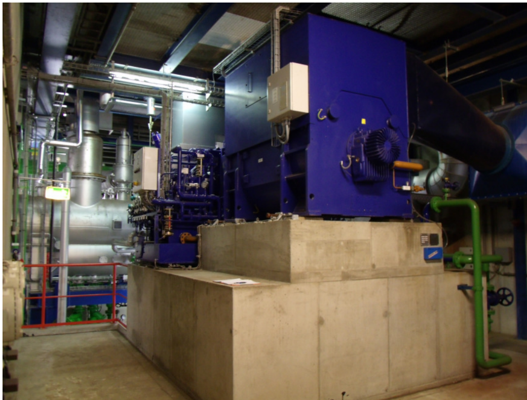
Bild 3: Fundament mit Generator, Getriebe, Ölversorgung und Dampfturbine
