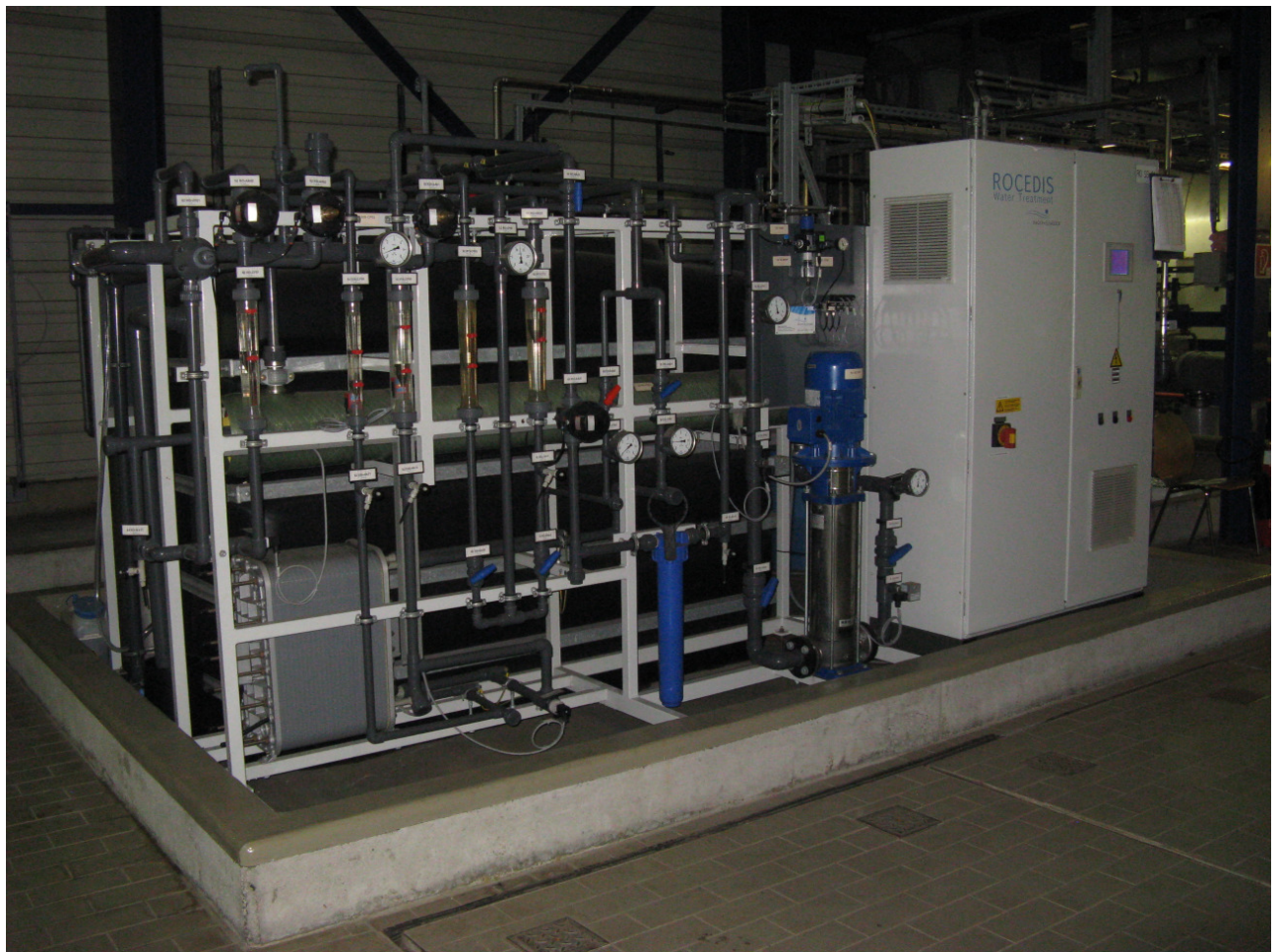
Bild 1: Vollentsalzungsanlage mit Auffangwanne
