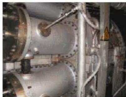
Bild 3: Erdgasbrenner und Brennkammer
