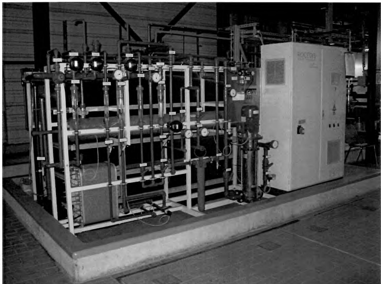
Bild 1: Vollentsalzungsanlage mit Auffangwanne
