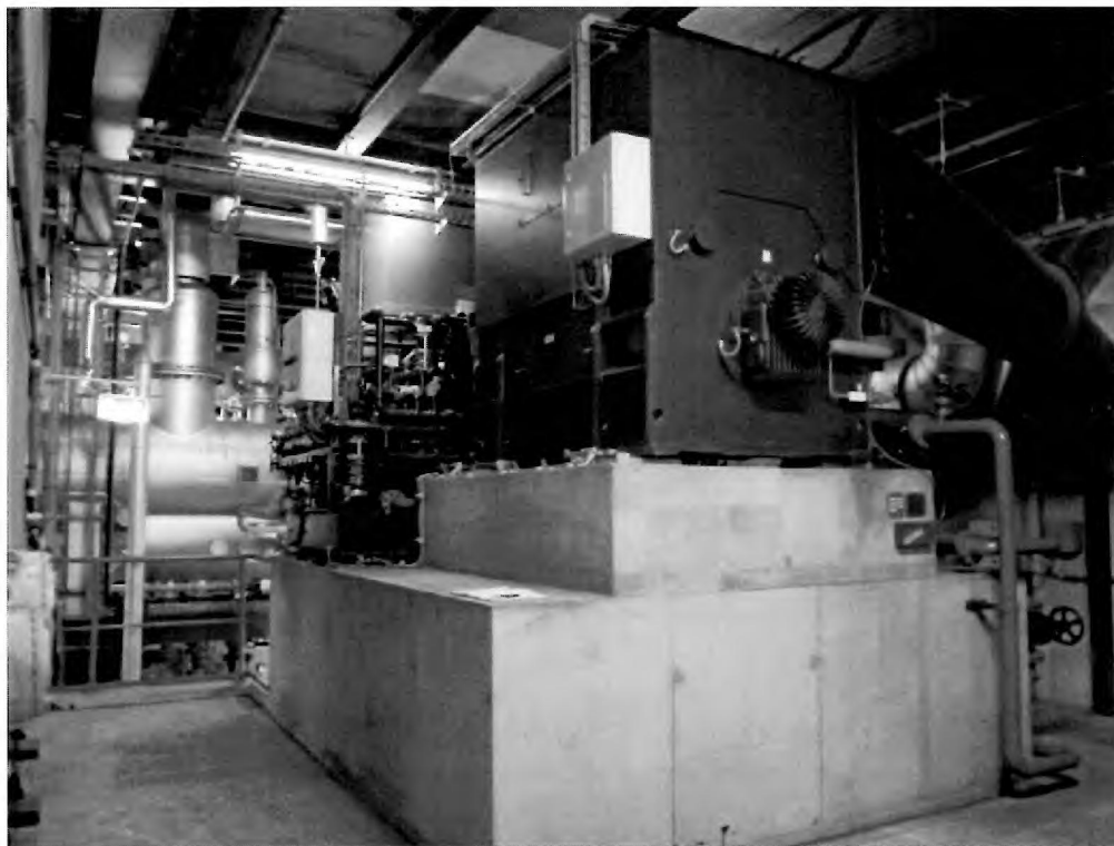
Bild 3: Fundament mit Generator, Getriebe, Ölversorgung und Dampfturbine
