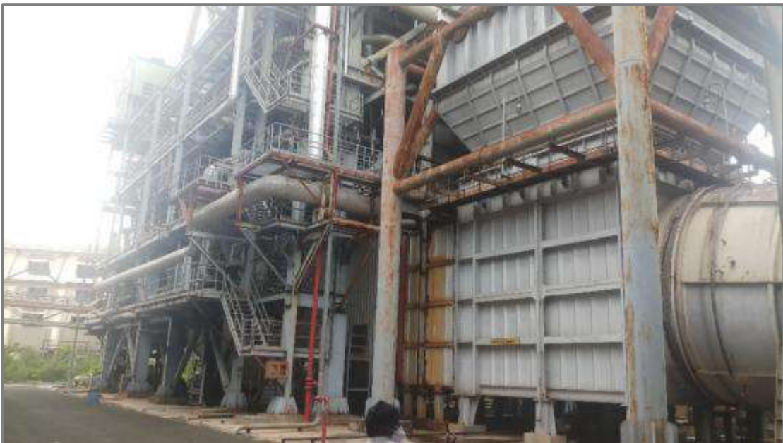
Corrosion on structures of HRSG # 1A and 1B
